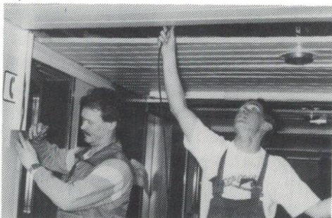
Boris Persson och Mattias Olsson installerar rökdetektorer.
